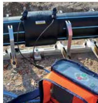
Distribución agua en zona portuaria
